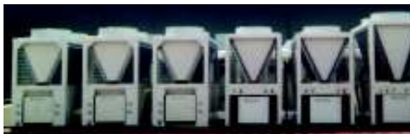
Gambar 2. Modular Chiller dengan 6 modul
