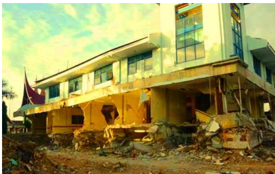
Gambar 1. Soft Storey gedung (Gempa Padang, 2009)
