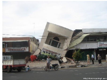
Gambar 1 Keruntuhan bangunan Soft-storey akibat Gempa Padang 2009
